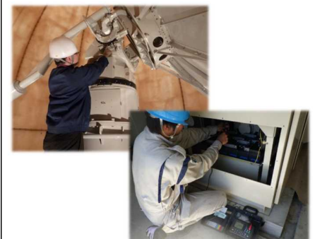
設備の定期点検・施設ごとの交換により、最善の状態を維持している例
