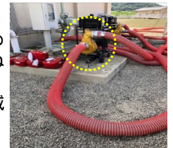
下水処理場等における仮設揚水ポンプの確保(イメージ)
