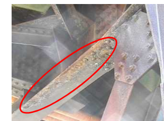
耐候性鋼材に層状の剥離
