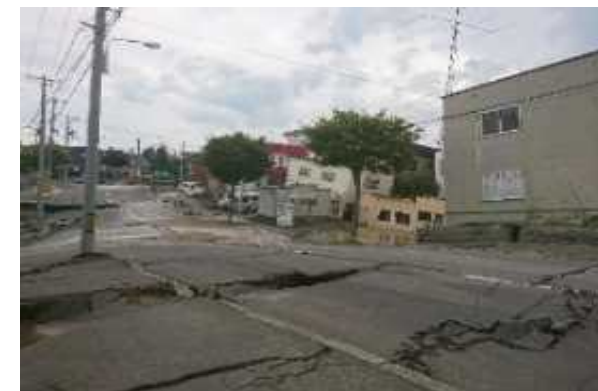
【宅地被害の状況】 (北海道札幌市清田区)
