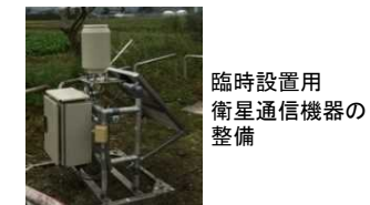
観測施設における非常用電源等の確保
