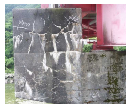
下部工にASRIによる劣化が疑われる
