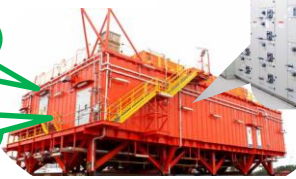
電気系統の統合制御設備
