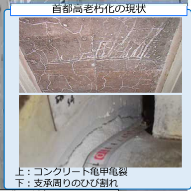
首都高老朽化の現状
