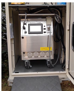
写真-2 可搬式小型バッテリーを使用した「蓄電システム」
