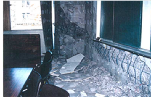
内部の被災状況
