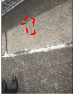
通報により判明した宅地の変状
