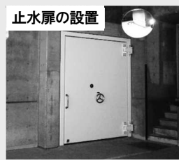
止水扉の設置 電源設備等の浸水対策による 電源機能の確保(空港)
