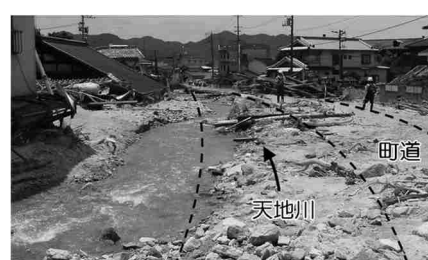
土砂・洪水氾濫による被害状況 広島県安芸郡坂町
