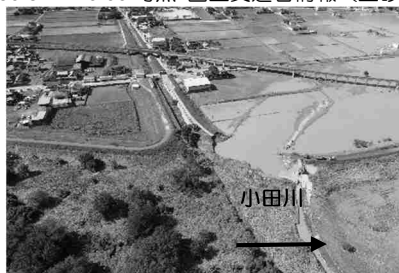
堤防決壊（高梁川水系小田川 左岸 6k4） 岡山県倉敷市真備町
