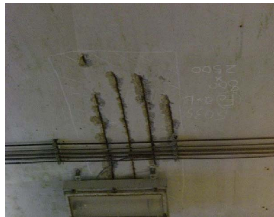
付写真-2.1.2 鋼材腐食の例
