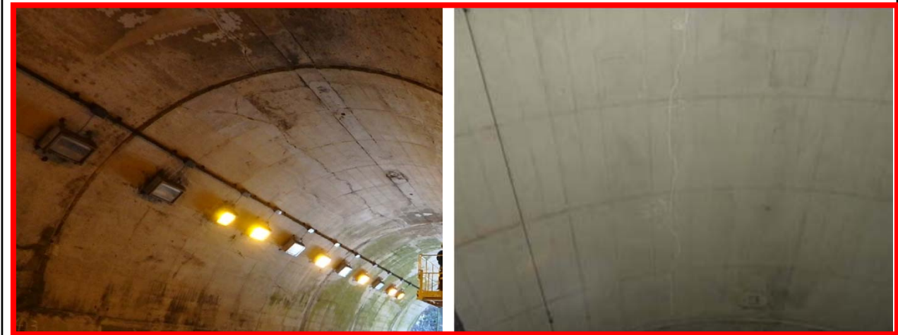
付写真-2.2.1 覆工の天端付近に発生した縦断方向のひび割れの例
