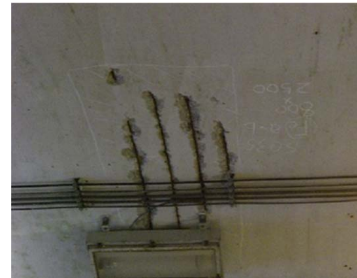
付写真-3.1.2 鋼材腐食の例
