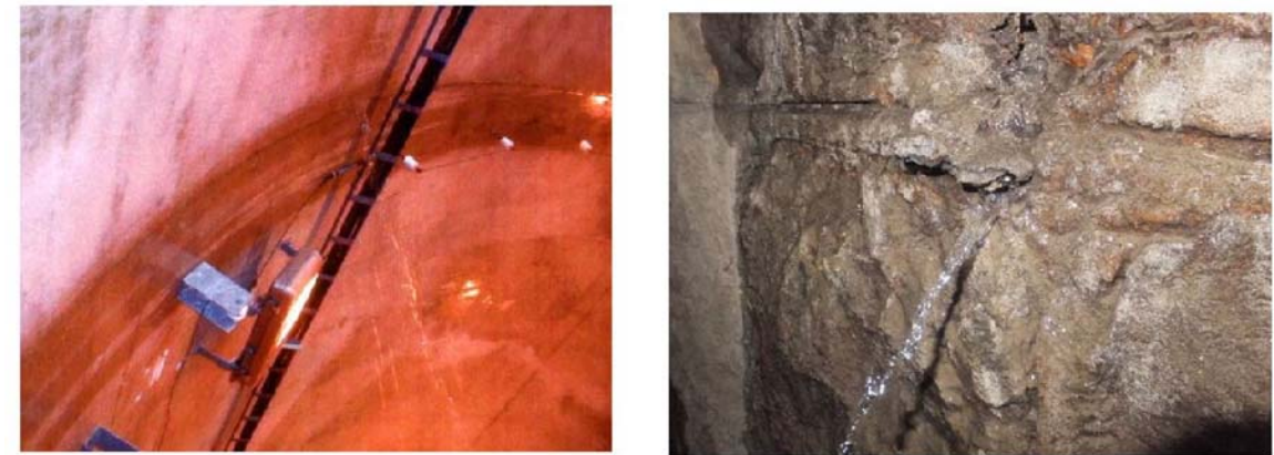
付写真-2.4.3 漏水（噴出）している例
