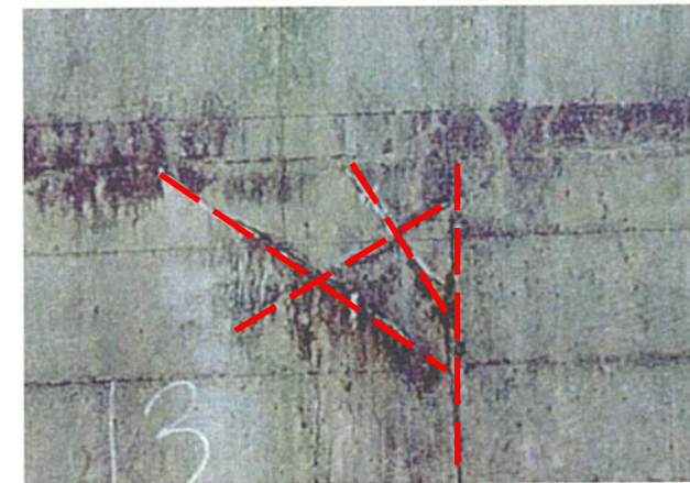
付写真-3.1.1 ブロック化したひび割れの例
