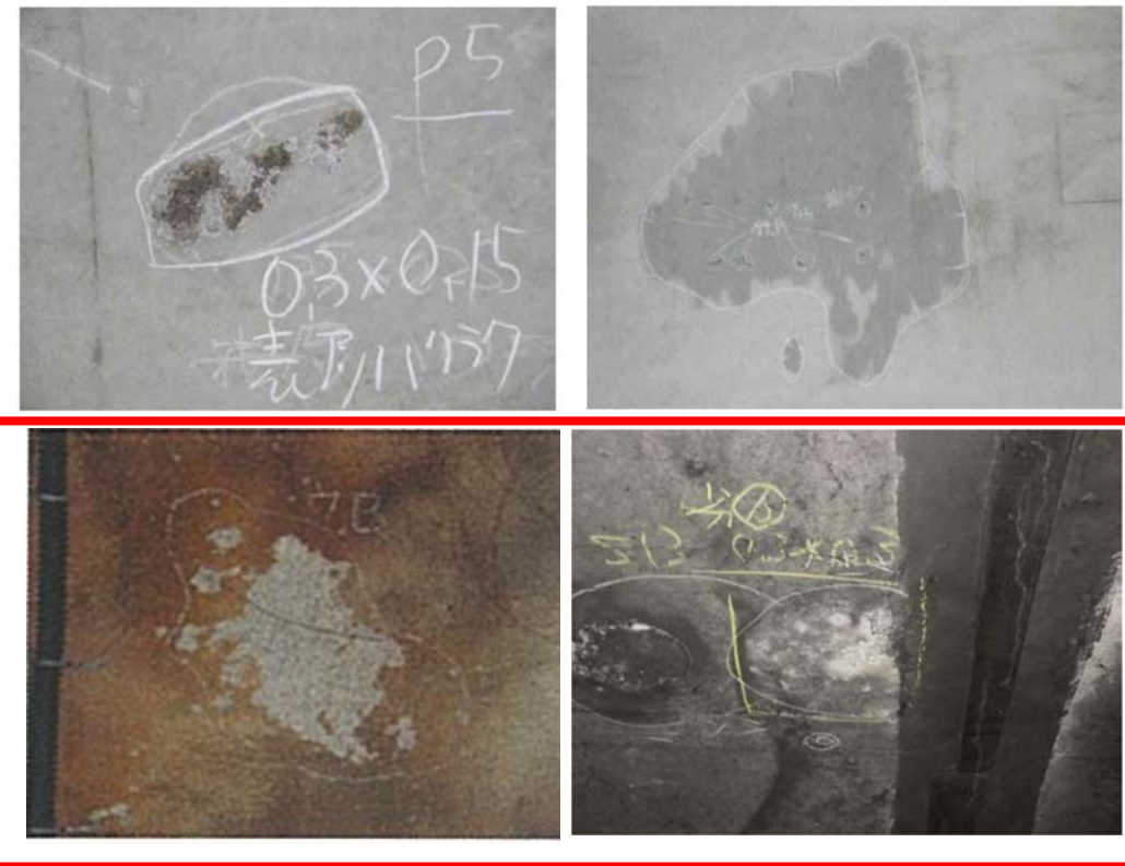
付写真-2.4.2 覆工コンクリートが変色している例 (うき・はく離を伴う)
