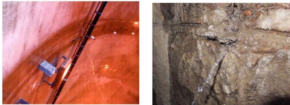
付写真-1.4.3 漏水（噴出）している例
