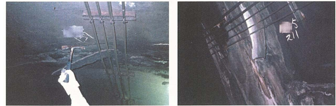
付写真-2.4.5 補修モルタルが劣化してはく離している例
