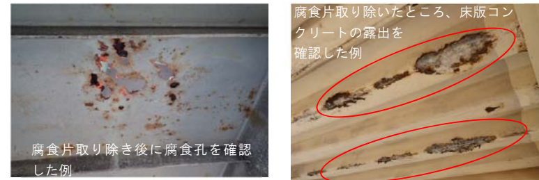
腐食片を取り除いた状態の例（床版）
