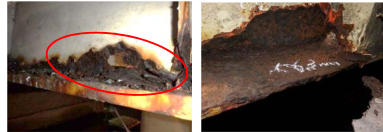
腐食片を取り除いた状態の例（主桁）
