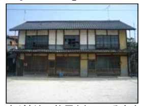
窓が割れ、放置されている空家
