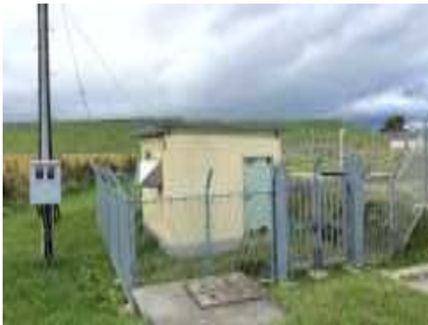
3117:汚水ポンプ室
