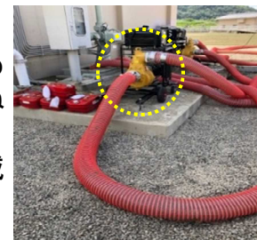
下水処理場等における仮設揚水ポンプの確保(イメージ)
