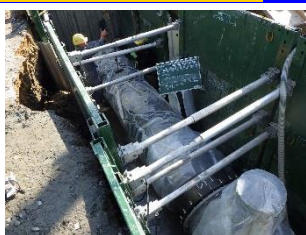
管路の耐震化
