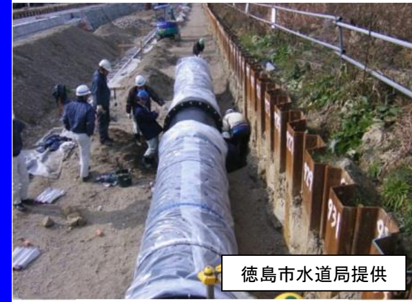
管路の耐震化
