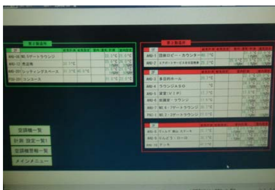
■ 空調設備コンピュータ管理（ターミナルビル）
