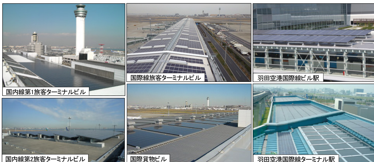
図-15 太陽光発電設備の設置例
