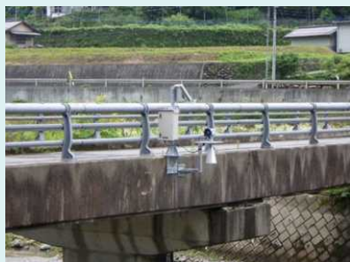
現場実装された危機管理型水位計
