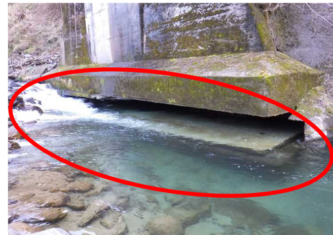
橋台基礎の大規模な洗掘を確認
