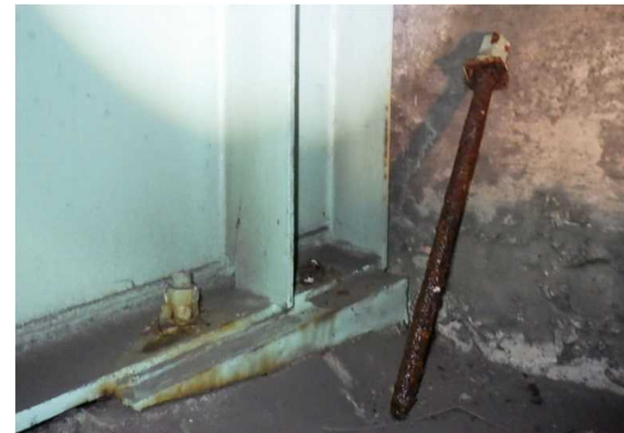
打音、触診により定着不良を確認
