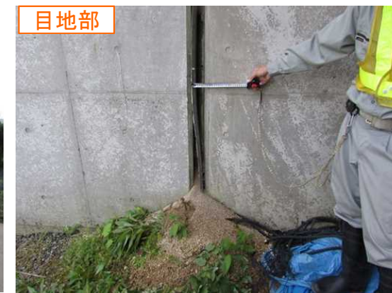
目地開き(供用後12年)
