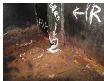
▲ 桁端部の腐食、断面欠損
