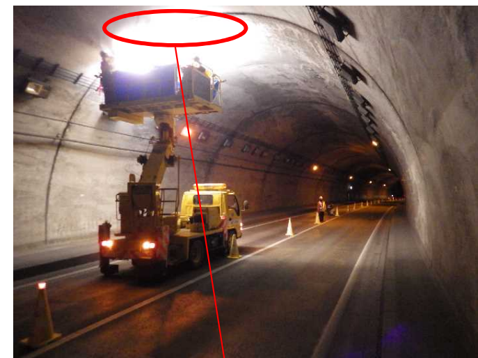
打音により確認された目地付近の「うき」
