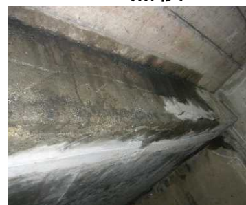
▲ 桁端部の漏水
