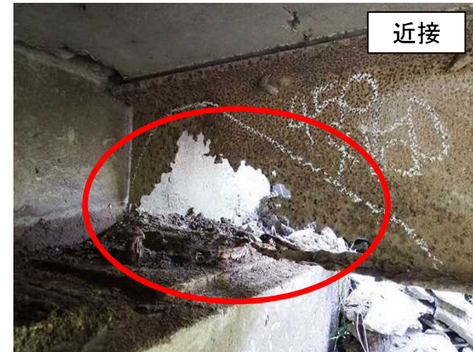
近接目視により断面欠損を確認
