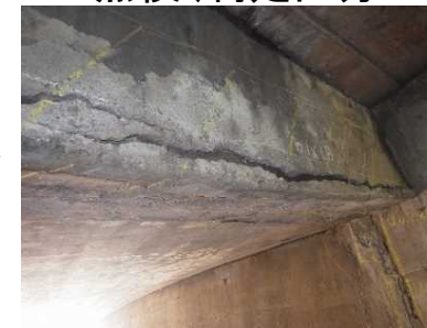
▲ 桁端部のひび割れ、うき
