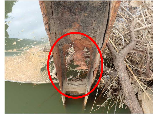
近接目視によりH鋼杭の断面欠損を確認
