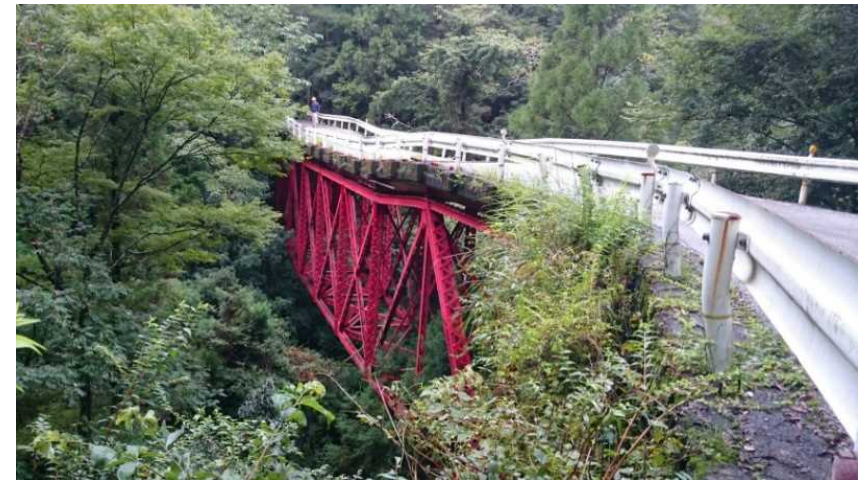
平成28年(点検から7か月後) 斜材4ヶ所の破断を発見
