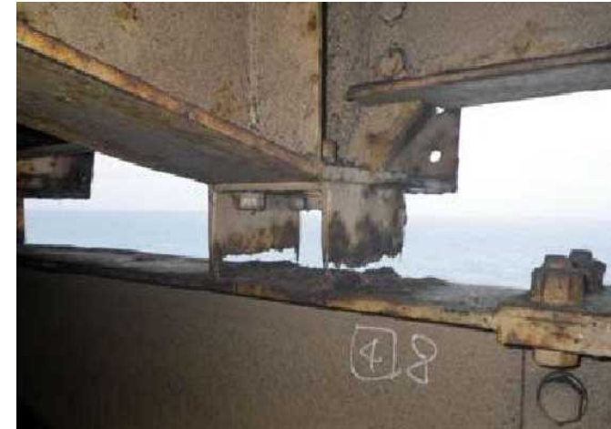
高所作業車による近接目視により破断を確認
