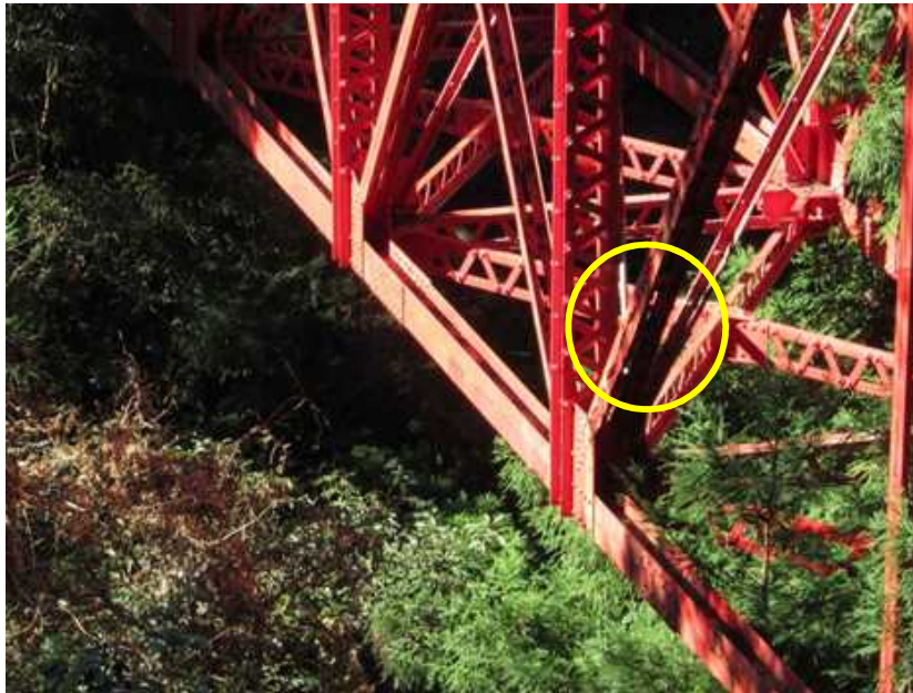
平成27年 定期点検 Ⅲ判定(腐食)
