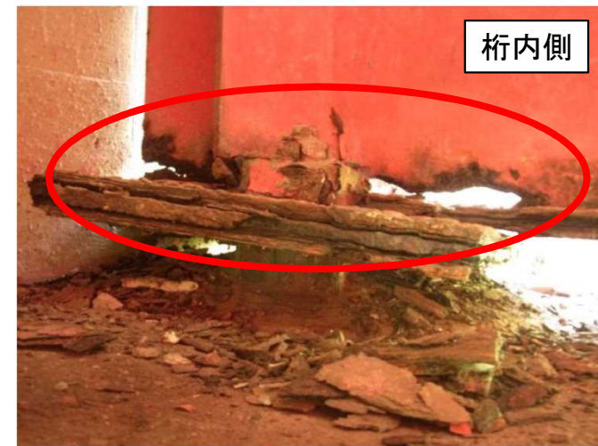
桁内側からの近接目視により断面欠損を確認
