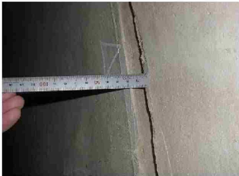
付写真-1.4.4 段差の例
