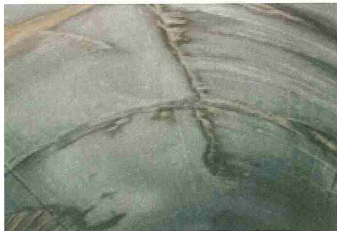
付写真-1.2.1 覆工の天端付近に発生した縦断方向のひび割れの例
