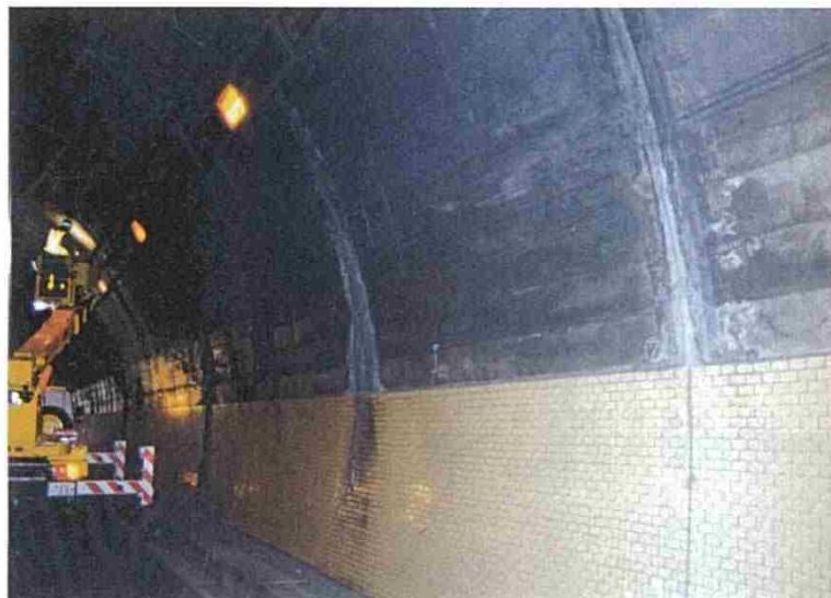
付写真-1.3.1 覆エスパンの中間付近に発生したひび割れの例
