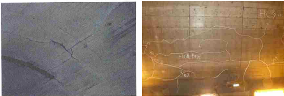
付写真-1.4.1 複数のひび割れで覆工コンクリートがブロック化している例
