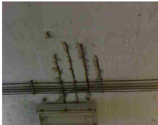
付写真-2.1.2 鋼材腐食の例
