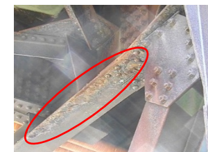
耐候性鋼材に層状の剥離
