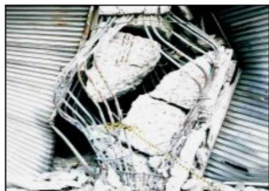
店舗1階柱の圧壊
