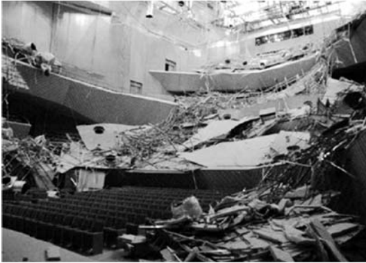
ホール天井の脱落
