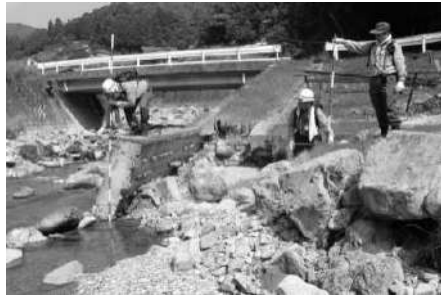
広島県広島市安佐北区河津川 河川被災調査
