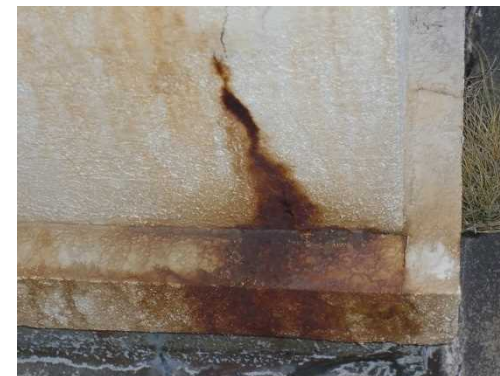
鉄筋の爆裂による錆汁、ひび割れが見られる
