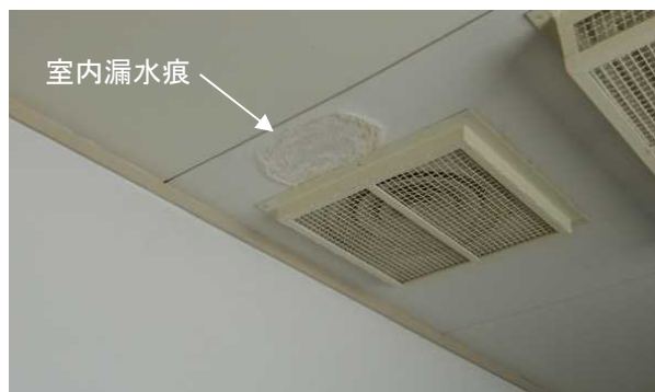
執務室天井に漏水が発生し、天井仕上の損傷が見られる
