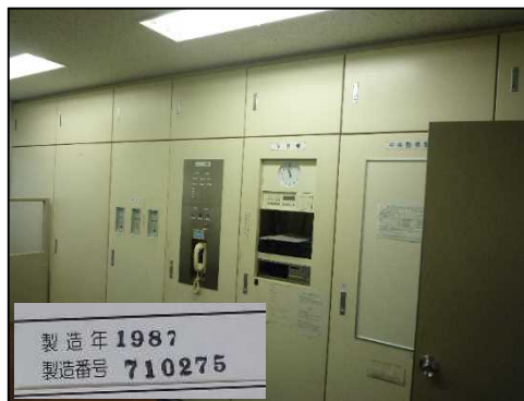
電気設備：動力設備等に劣化が見られる
