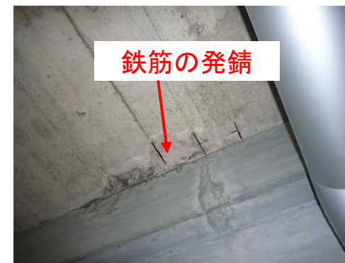
天井：漏水により、鉄筋の発錆が見られる
