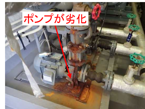
機械設備：空調用ポンプに発錆等の劣化が見られる
