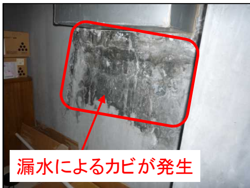
内壁：ひび割れによる漏水及び仕上げの劣化が見られる
