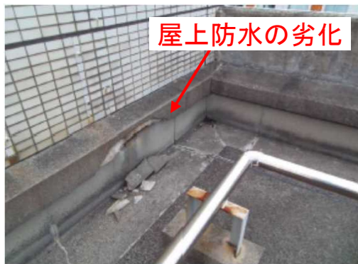
屋上：屋上防水の劣化が見られる
