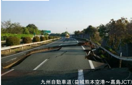
熊本地震の被災状況
