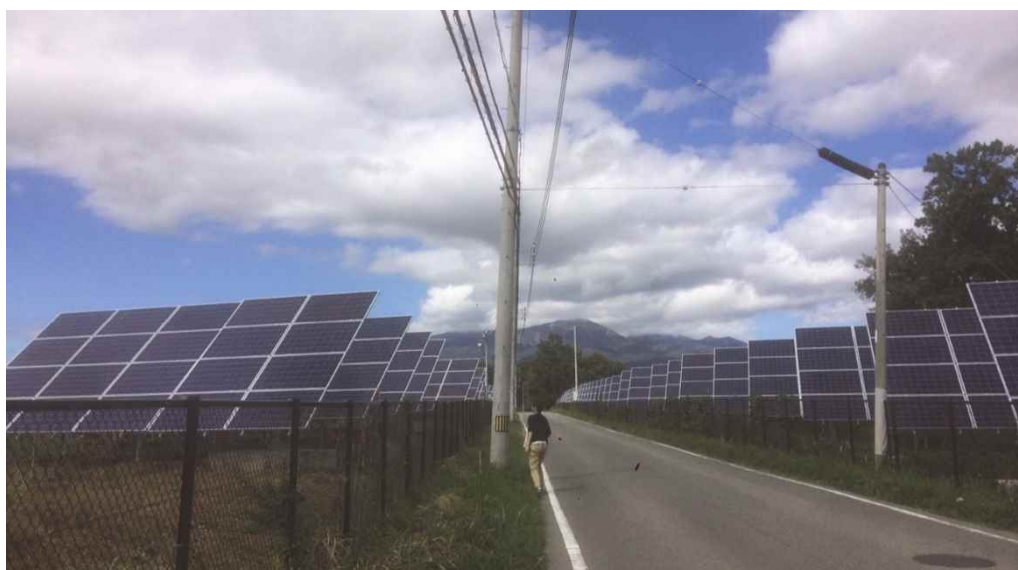
図4-3. パネルの角度が大きい設備 (2017年10月4日撮影)
