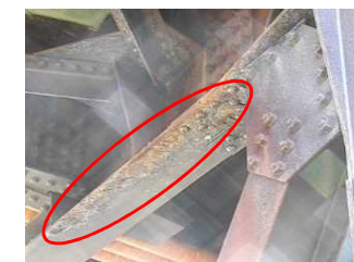
耐候性鋼材に層状の剥離
