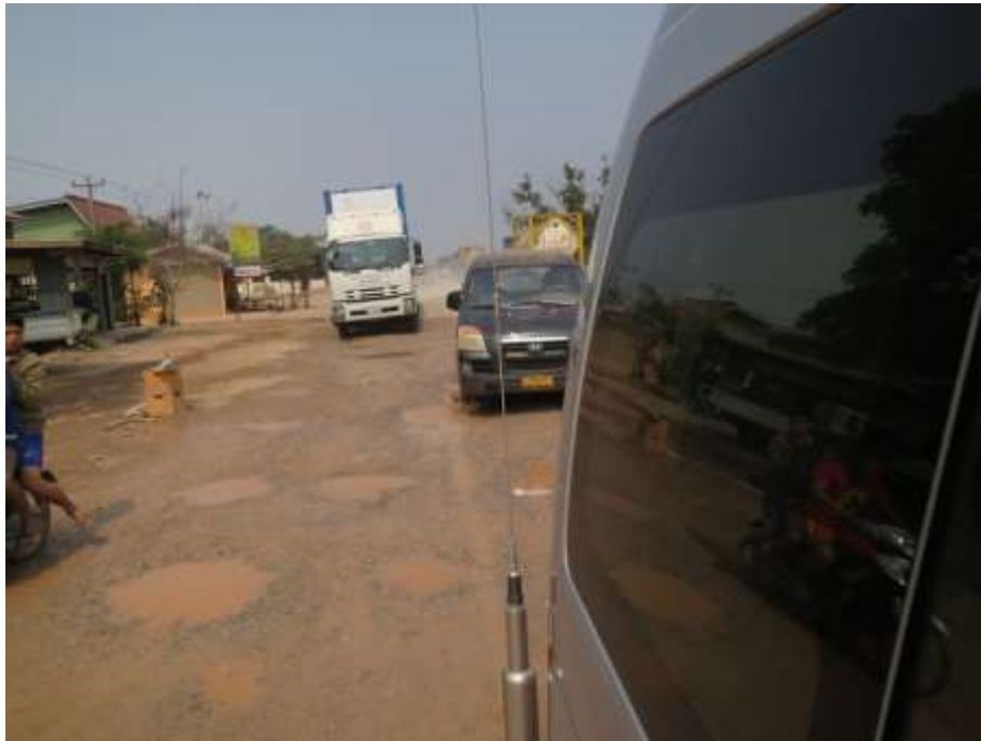
図 ラオス国内の陥没した道路 (9 号線)
