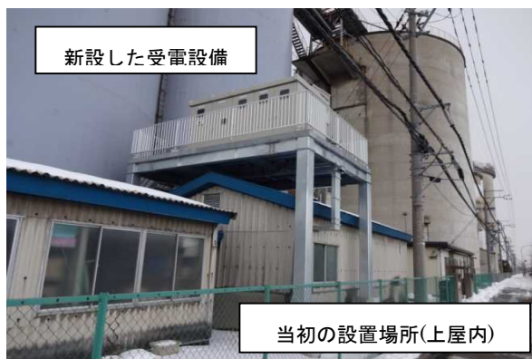
写真 2.2.1 対策実施後の設備
