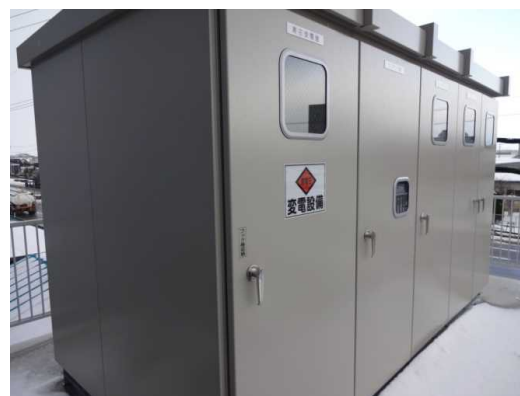
写真 2.2.2 新たに設置した受電設備
