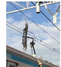
架線工事での施工不良によるパンタグラフの損傷 (出典:JR東日本)
