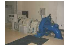
水力発電設備
