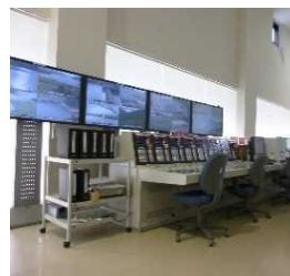
ダム制御装置 (ダムコン)
