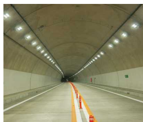
トンネル照明
