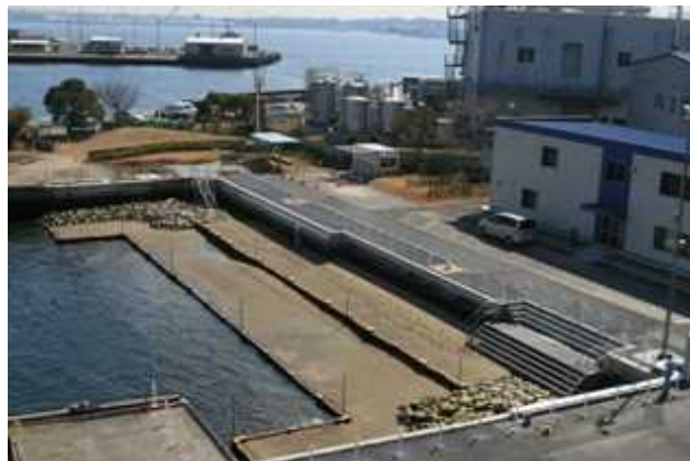
老朽化した護岸に生物共生効果をも併せ持つ「護岸」と「磯場」を設置
