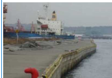
被災事例(岸壁のはらみ出し)
