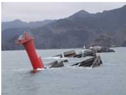
東日本大震災の津波により倒壊した防波堤の事例
