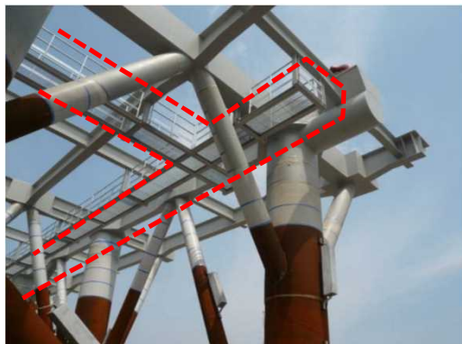
維持管理を容易にする点検歩廊の設置事例
