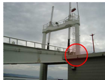
可動橋被災箇所
