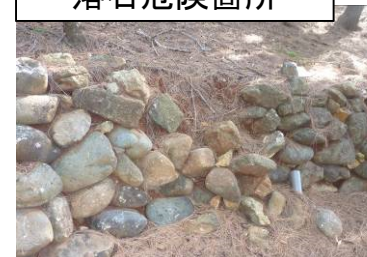
落石危険箇所
