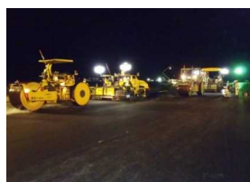
(老朽化した滑走路舗装の改良)
