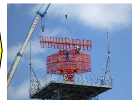
(老朽化した空港監視レーダーの更新)
