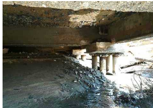
建物基礎が露出
