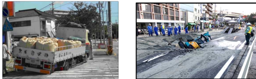
←上下水道等の老朽化に伴う道路陥没
