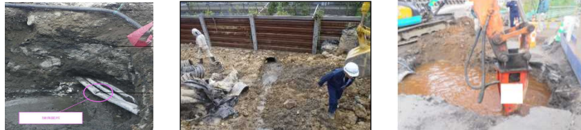
工事に伴う埋設物の損傷事故
