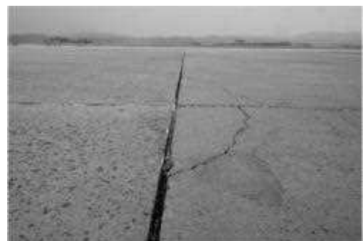
写真-3 隅角部ひび割れと剥離
