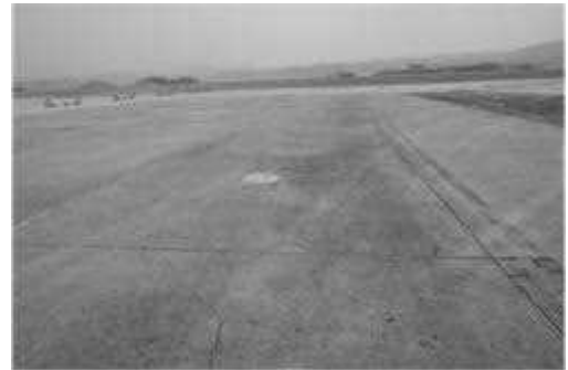
写真-5 版中央縦横断ひび割れ
