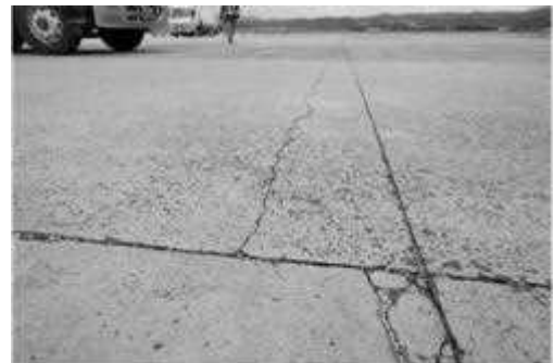
写真-4 版端部縦横断ひび割れ
