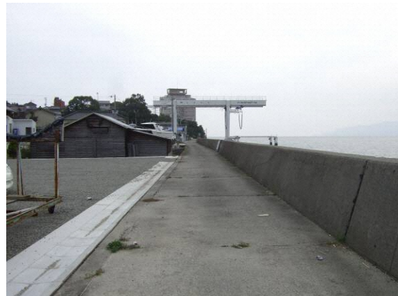
⑯海岸堤防 マリーナ裏を通る管理用通路は歩行可能な空間となっている。
