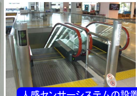
人感センサーシステムの設置
