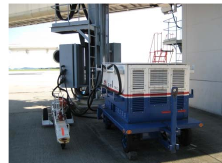
GPU(地上動力設備)4台配備
