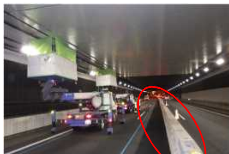
<移動式コンクリート防護柵>
