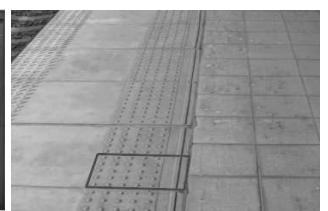
内方線付き点状ブロック
