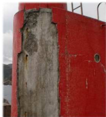
タイルの剥離
