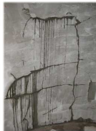
室内への漏水
