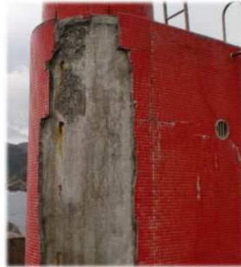
タイルの剥離
