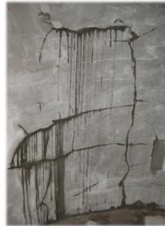
室内への漏水
