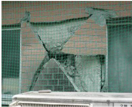
(a) 非耐力壁の被害
