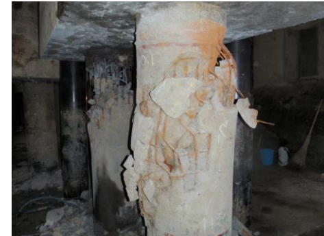
(c) 既成杭の被害
