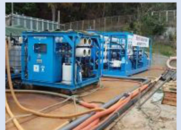
海水淡水化装置
