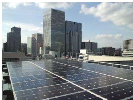
屋上太陽光パネル
