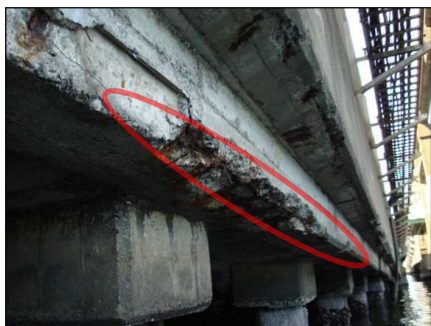
写真-1 コンクリートの剥離、鉄筋腐食
