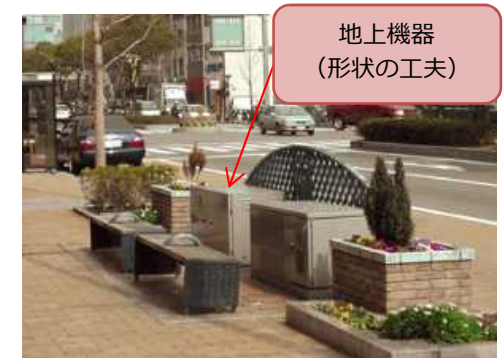
地上機器の工夫事例（神戸市）
