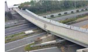
跨道橋の落橋
