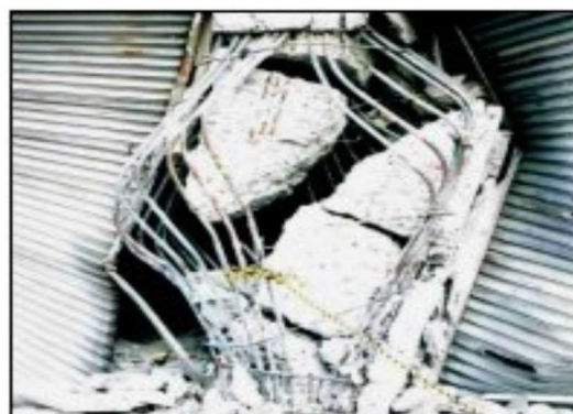
店舗1階柱の圧壊
