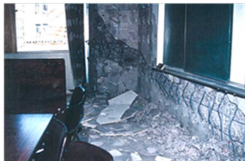
内部の被災状況
