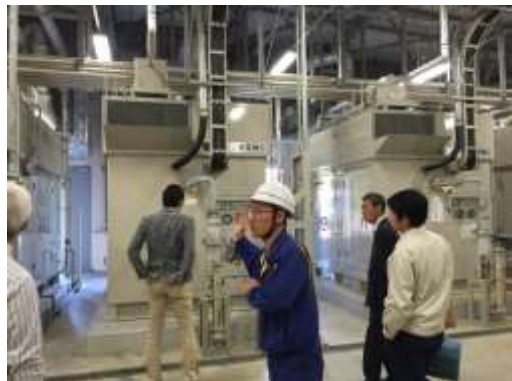
発電機（80kW×5台）
