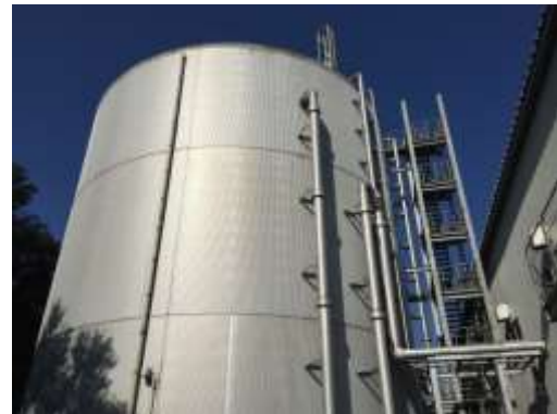
メタン発酵槽
