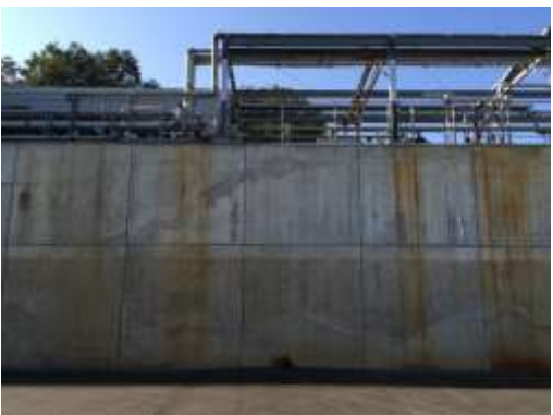
排水処理設備（停止中）
