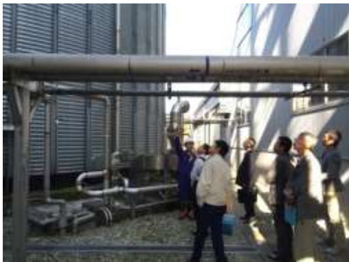
ガスホルダーと冷却水の送水管
