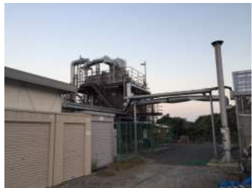
竹ガス化施設（停止中）
