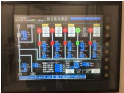
電力監視画面
